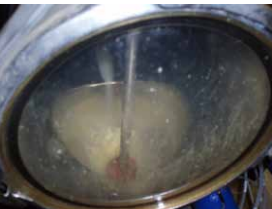
Mælkerester i pumpebrønd
