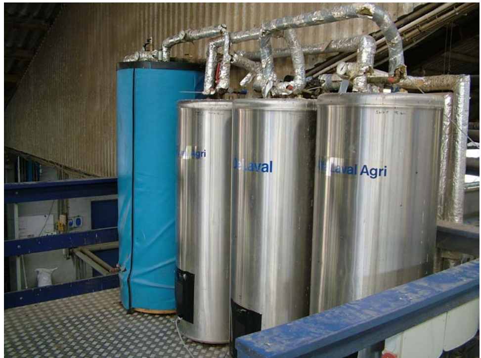
Akkumuleringstank (blå beholder) til forvarmet vand fra varmegenvinding. Beholderen forsyner el-vandvarmerne til malkerobotterne. El-vandvarmerne er seriemonteret
